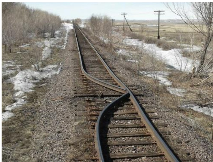
Рис. 1. Температурный выброс пути с изломом накладки
